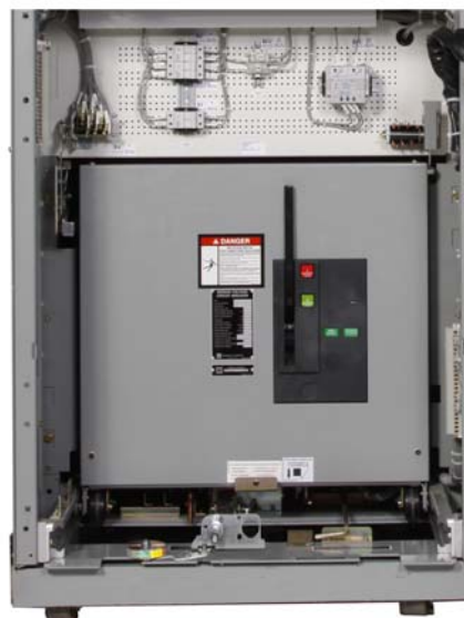
Figure 15 : Disjoncteur type VR dans la position ESSAI/DÉBROCHÉ (compartiment inférieur)
