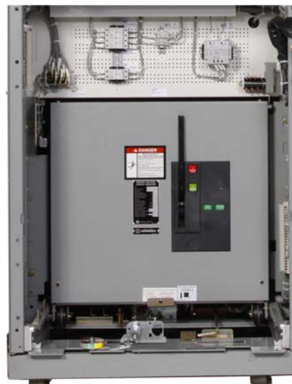
Figura 15: Interruptor automático tipo VR en la posición de PRUEBA/DESCONECTADO (compartimiento inferior)
